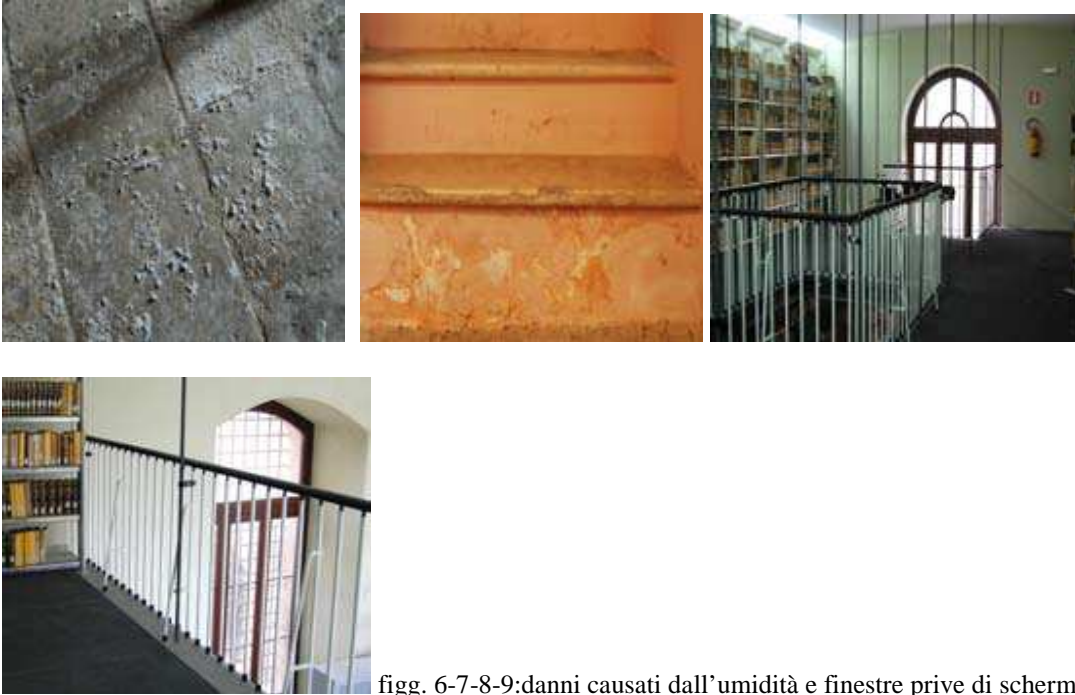
figg. 6-7-8-9:danni causati dall'umidità e finestre prive di schermature
